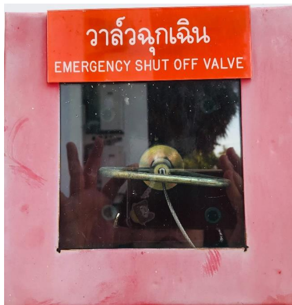
รูปที่ 4-9 Emergency Shut-Off Valve หรือ วาล์วนิรภัยฉุกเฉิน
