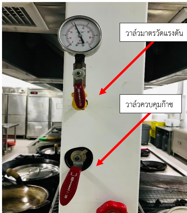
รูปที่ 4-8 วาล์วมาตรวัดแรงดัน และวาล์วควบคุมก๊าซ
