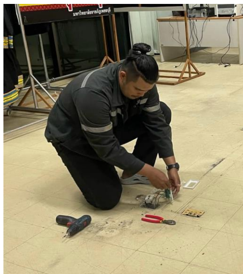
ภาพที่ ๕ แสดงการตรวจเช็คสภาพของสายไฟ
